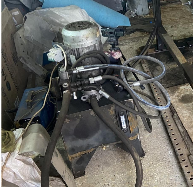
Рисунок 3.4 – Масляная станция (гидропривод)
